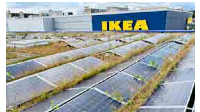
Photovoltaikanlage IKEA Dietlikon.
